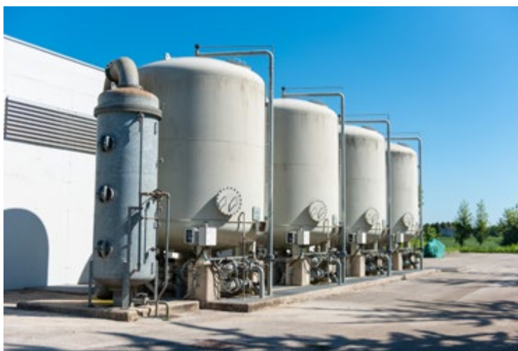
Viacqua / Fitti, presso la Centrale idrica nella frazione di Beresina (Vicenza)
